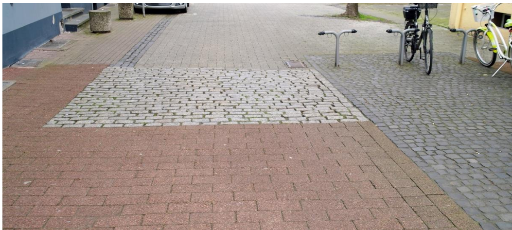
Abbildung 39: Uneinheitlicher Bodenbelag, fehlendes (taktiles) Leitsystem
